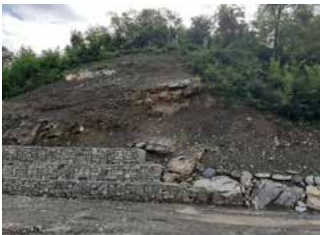
Situazione versante sottoscarpa Ferriere preintervento
