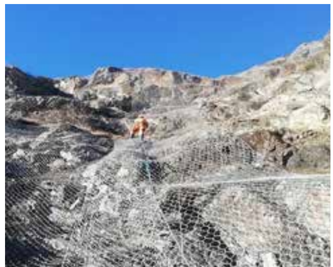
Rete Paramassi potenziata ArrFort - Val d'Ossola (VB)
