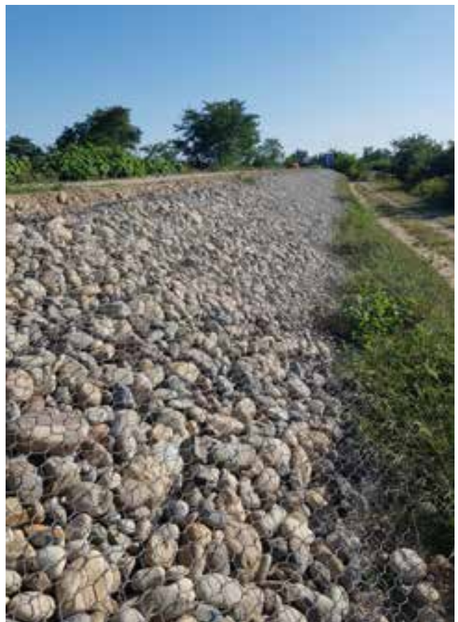
Rivestimento arginale - Balocco (VC)
