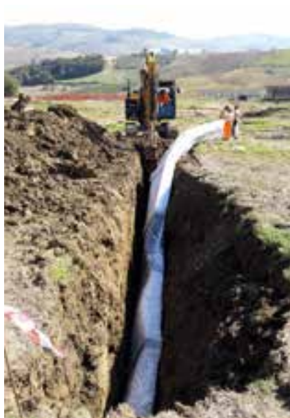
Drenar posa in continuità in terreni spingenti campo fotovoltaico Volturara Appula (FG)
