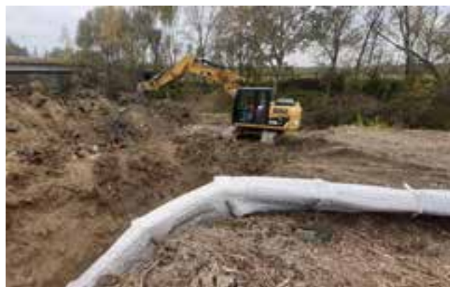
Drenar in ripristino frana d'alveo, in dettaglio l'elevata flessibilità dei moduli - Cesena
