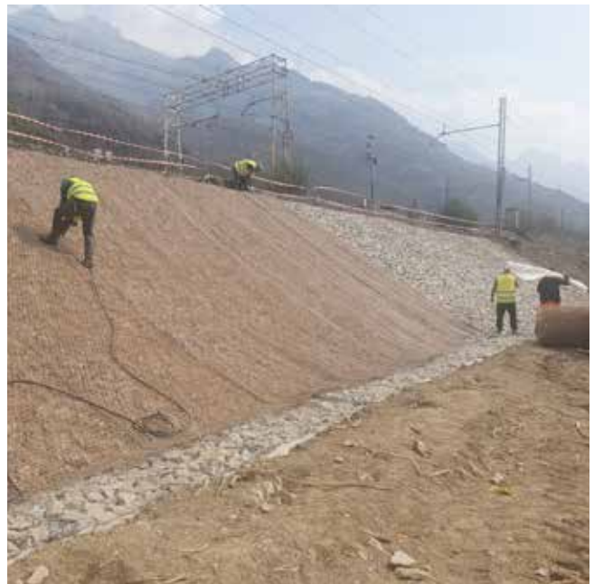
Rivestimento antierosivo misto con Arrldro e materassi di sottoscarpa ferroviaria - Domodossola (VB)
