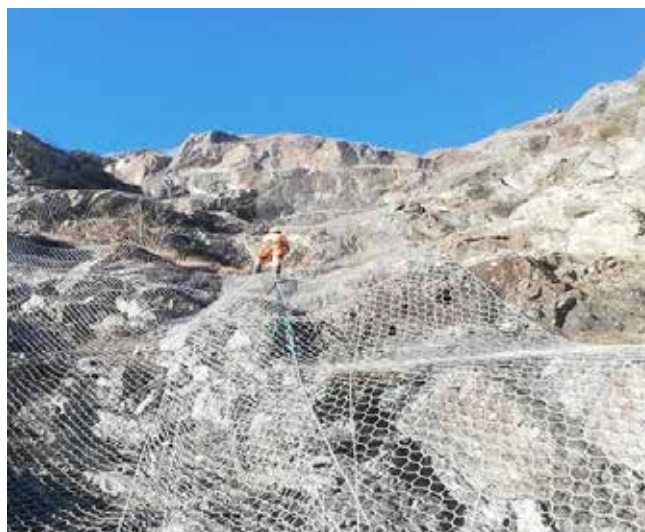
Rete Paramassi potenziata ArrFort - Val d'Ossola (VB)
