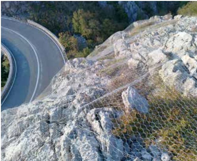
Rete paramassi posata in Croazia
