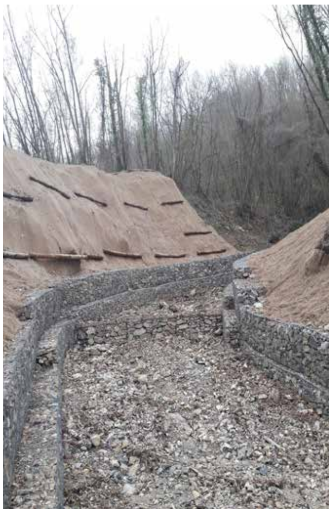
Sistemazione idraulica e stabilizzazione versanti a basso impatto gabbioni e geocomposito Arco - Genova
