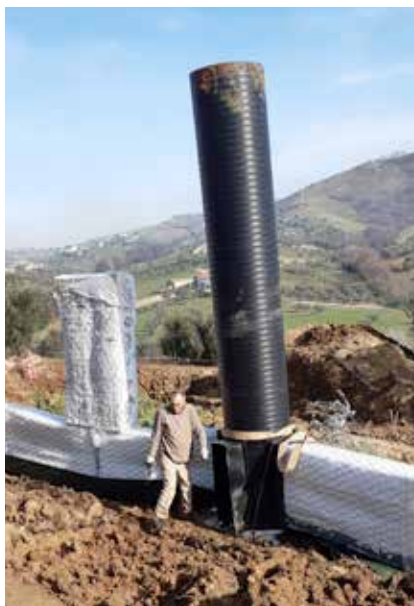
Innesto Drenar con guaina e camini drenanti in pozzetto prefabbricato fuori scavo - Tortoreto (TE)
